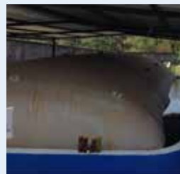
4. Biodigestor tratamiento aguas residuales en 10 celdas anaeróbicas
